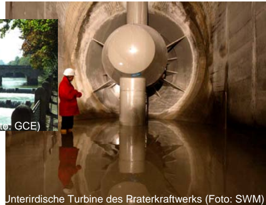
Unterirdische Turbine des Praterkraftwerks (Foto: SWM)
